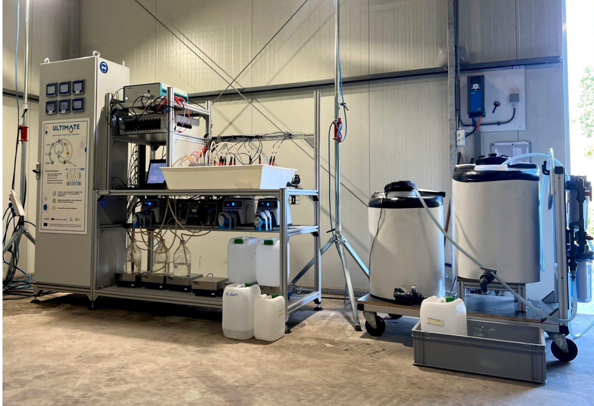
Pilot plant op locatie bij De Vlot
