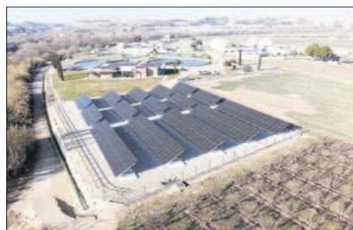
705 plaques solars li garanteixen una elevada potència fotovoltaica.
